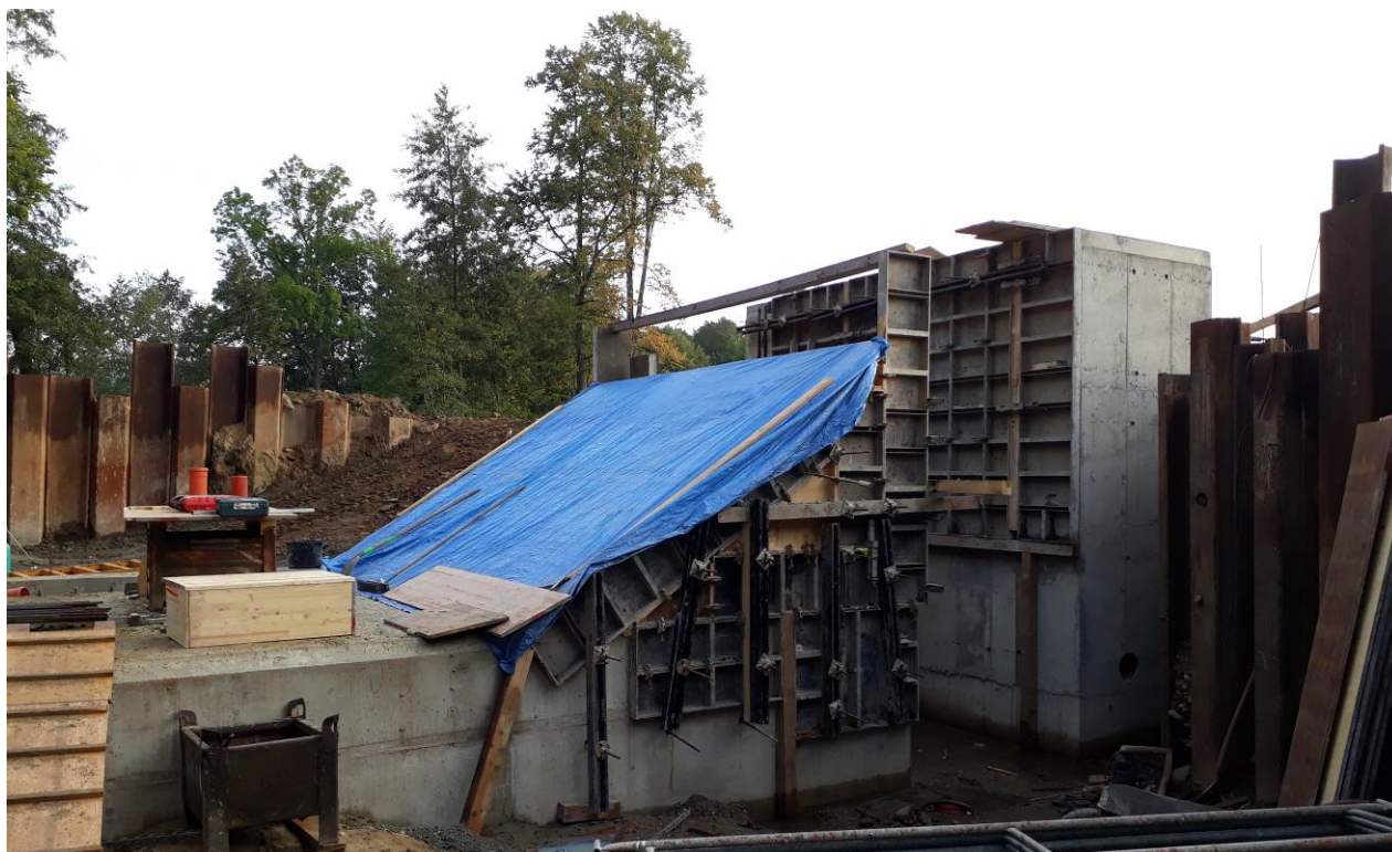
Obrázek 3: armaturní šachta a šikmina vaku na jezu Červený dvůr
