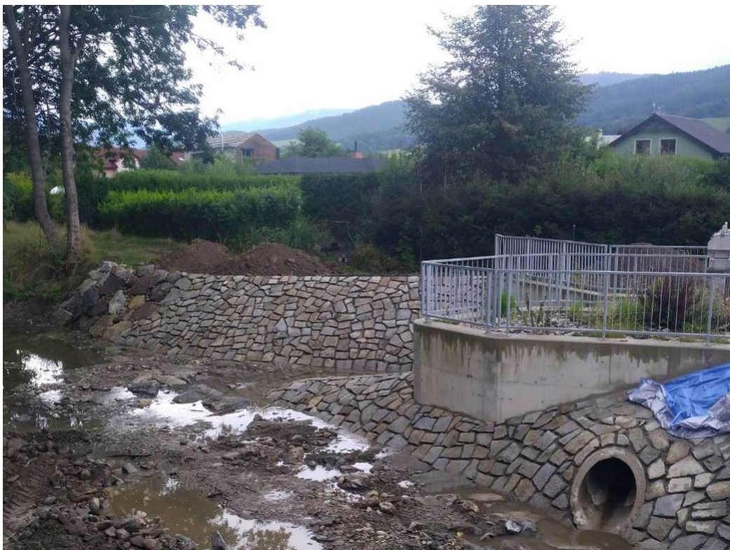
Obrázek 3: dlažby na objektu SO26
